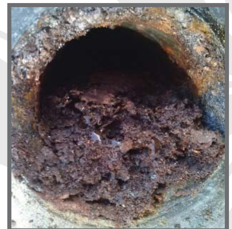
Трубопровод слива рекуперата
