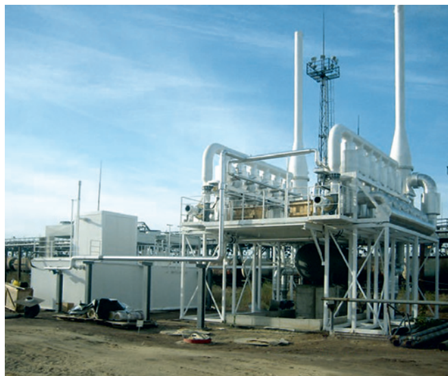
Рис. 2. ККР 5000 производительностью 5000 м 3 /ч. ООО «ЛУКОЙЛ-Волгограднефтепереработка»
